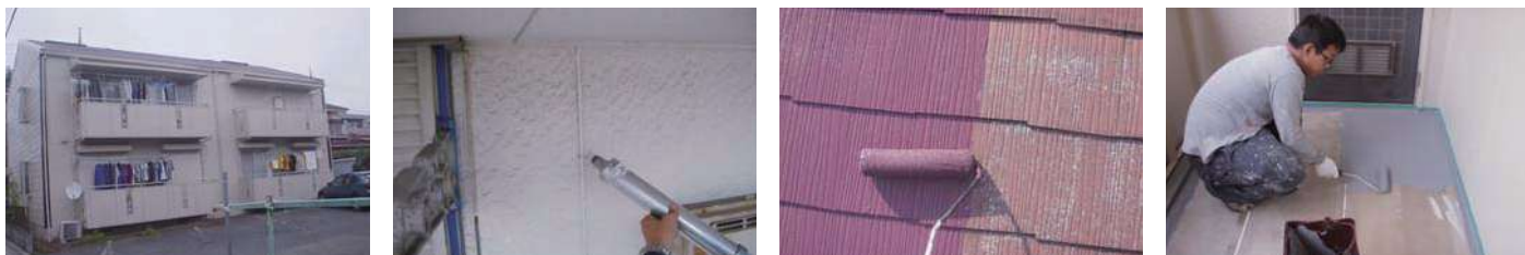
35 物件名 ▶ 鈴屋ビル(杉並区荻窪) 施工期日:平成22年11月/施工内容:屋上防水
