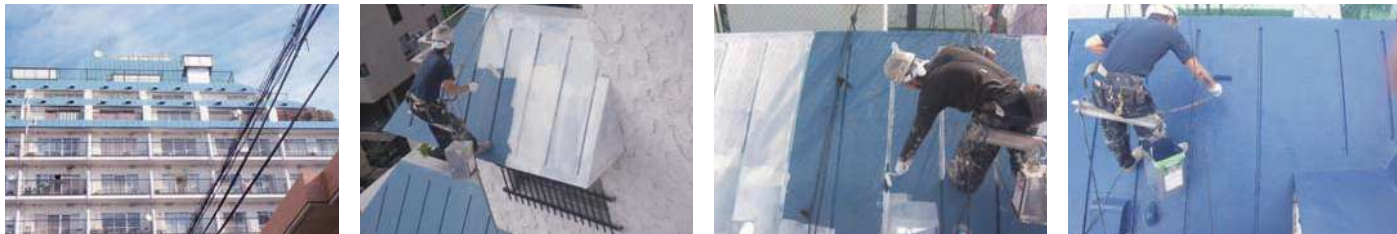
33 物件名 ▶ サンヒルズ東川口(川口市東川口) 施工期日:平成22年10月/施工内容:外部改修
