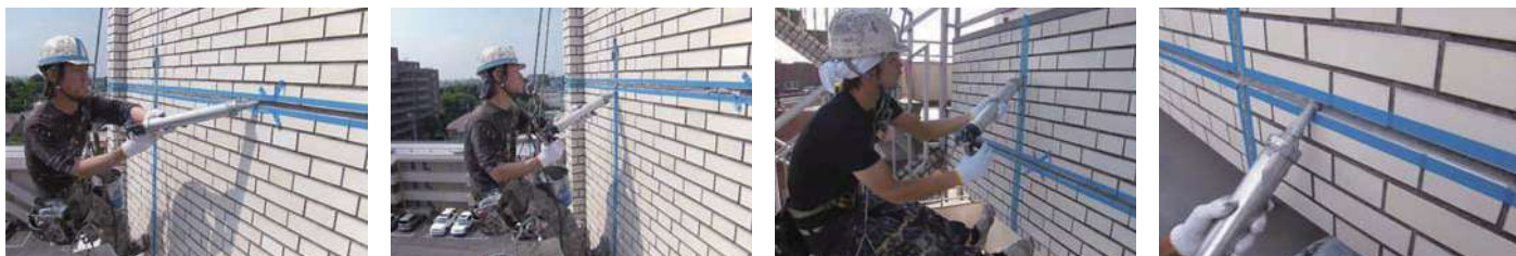
22 物件名 ▶ 向島東田ビル(墨田区向島) 施工期日:平成22年7月/施工内容:外部改修
