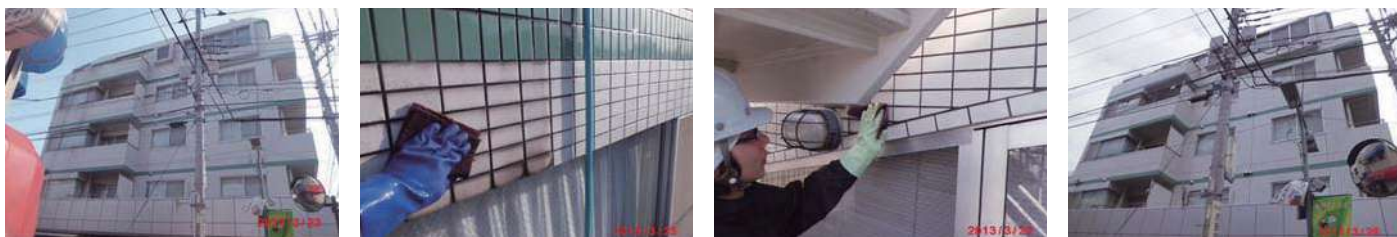
14 物件名 ▶ 第一高野ビル(杉並区高円寺北) 施工期日:平成25年3月/施工内容:屋上、ルーフバルコニー防水工事
