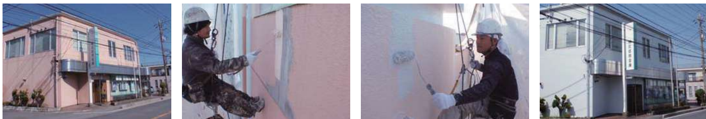
17 物件名 ▶ オスカービル(中野区中野) 施工期日:平成25年4月/施工内容:屋上防水、南面改修工事
