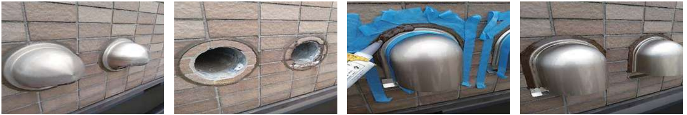
131 物件名 ▶ 弘城社員寮(大田区西蒲田) 施工期日: 令和5年10月 / 施工内容: 北西面外部改修工事
