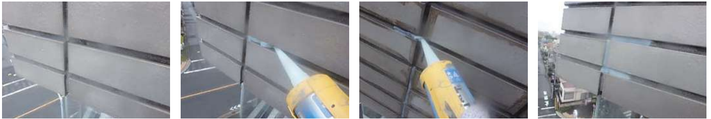
70 物件名 ▶ 第二梶幸ビル(千代田区岩本町) 施工期日: 令和5年6月 / 施工内容: 室内塗装工事
