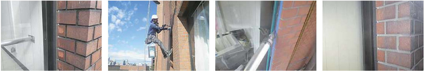
130 物件名 ▶ メゾン・ド・ペペ(北区滝野川) 施工期日: 令和5年10月 / 施工内容: ベントキャップ交換、他工事
