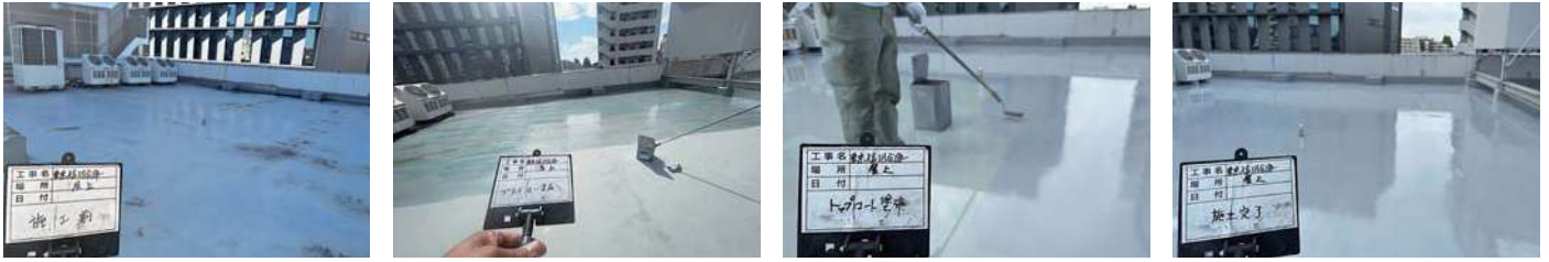
128 物件名 ▶ 東京信用金庫中野坂上支店(中野区中央) 施工期日: 令和5年10月 / 施工内容: 漏水補修工事
