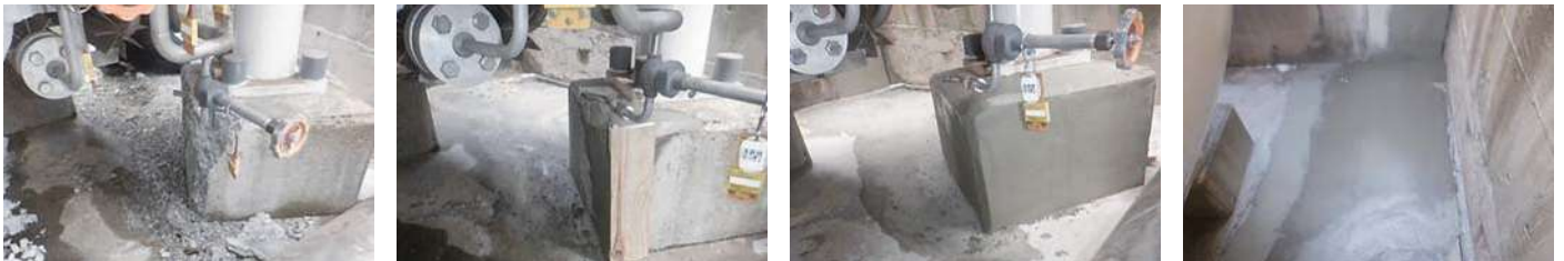
29 物件名▶平井様邸(新宿区百人町) 施工期日:令和5年2月/施工内容:塗装工事
