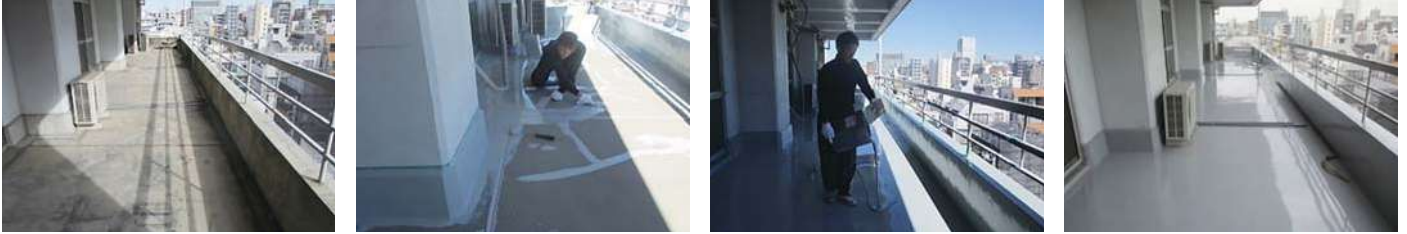
21 物件名 ▶ 小島町ハイツ(台東区小島) 施工期日: 令和5年2月 / 施工内容: 屋上防水工事、鳩除けネット設置工事
