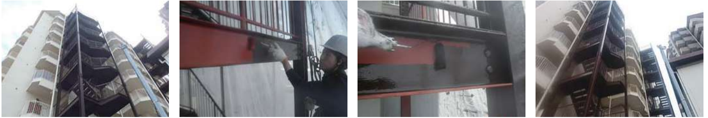
57 物件名 ▶ 大島ビル(台東区三筋) 施工期日: 令和5年5月 / 施工内容: 正面5階バルコニー工事
