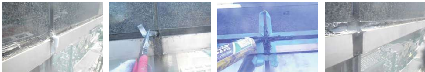
32 物件名 ▶ 西条護謨ビル(台東区台東) 施工期日: 令和7年4月 / 施工内容: カーテンウォール部シーリング工事
