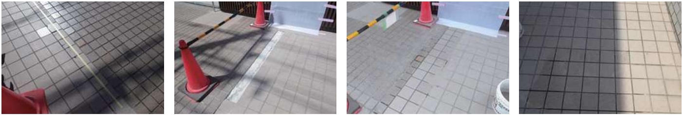
45 物件名 ▶ 浅草 葵丸進(台東区浅草) 施工期日: 令和7年5月 / 施工内容: 漏水箇所補修工事
