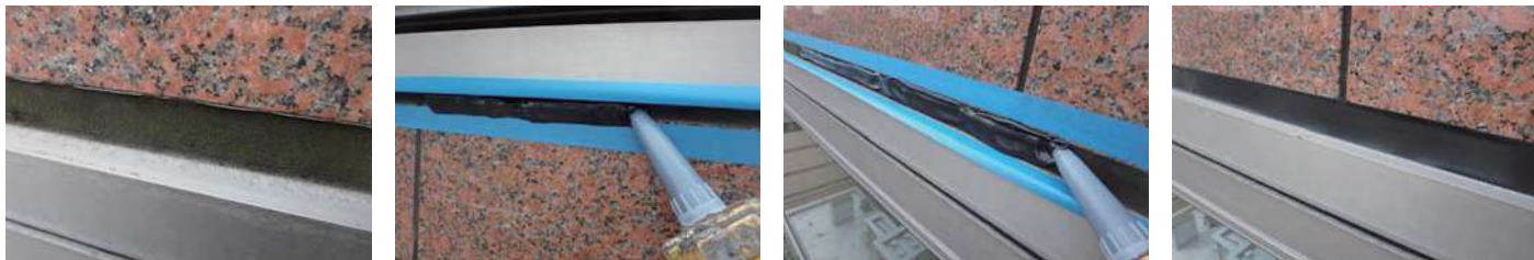
34 物件名 ▶ ベルシャトル武藤(蕨市中央) 施工期日: 令和7年4月 / 施工内容: 北面サッシ漏水補修工事
