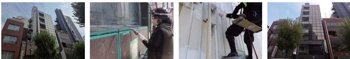
94 物件名 ▶ 浅草橋丹羽ビル(台東区柳橋町) 施工期日: 令和7年9月 / 施工内容: 5階漏水箇所調査補修工事
