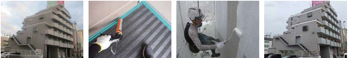
53 物件名▶フォーラムコート(大田区池上) 施工期日: 令和7年6月 / 施工内容: シーリング工事・鉄部塗装工事
